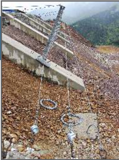
System vor MEL-Test
