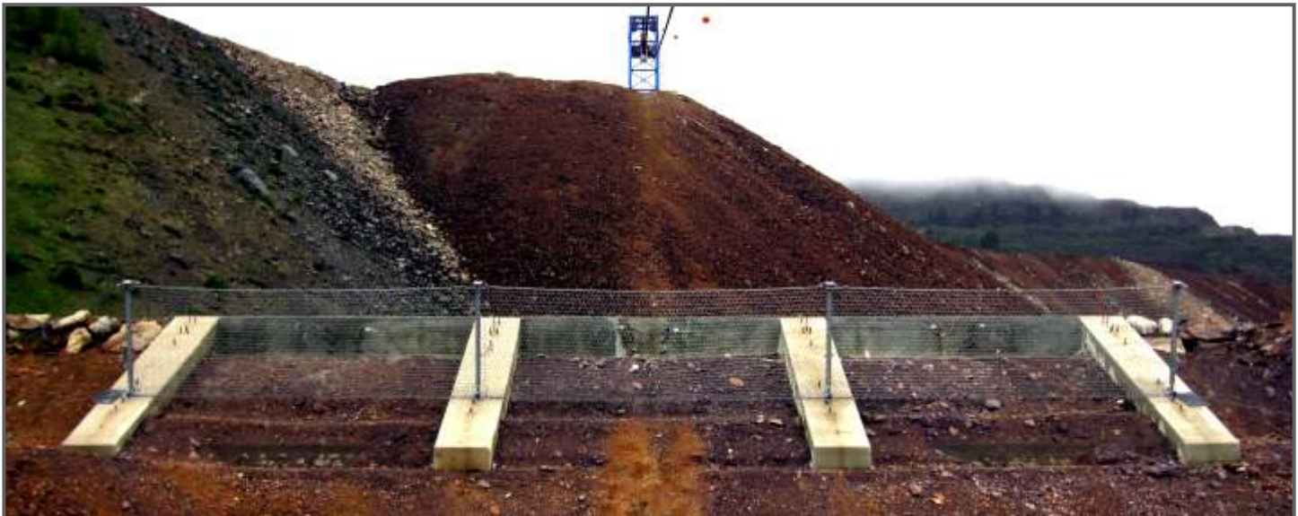
System vor MEL-Test
